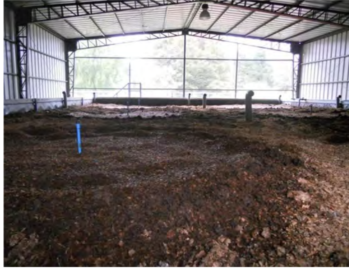
Figura 13: Sistema de tratamiento secundario Lombifiltro.
