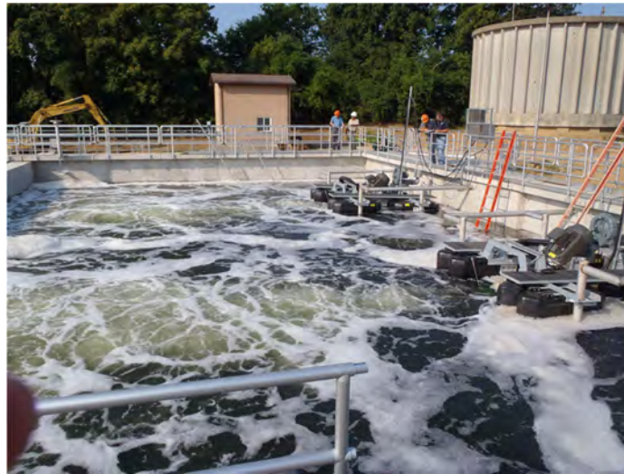
Figura 12: Sistema de tratamiento terciario SBR.
